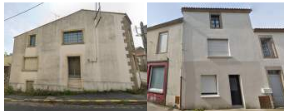
Fig. 70. Exemples d'élargissement inesthétique des percements existants
