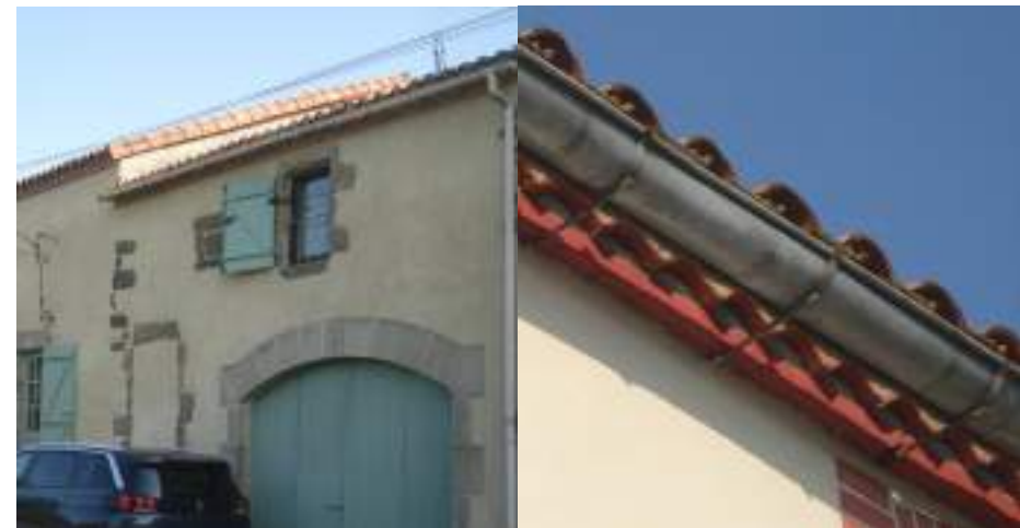
Fig. 76. Exemples de gouttières masquant les corniches
