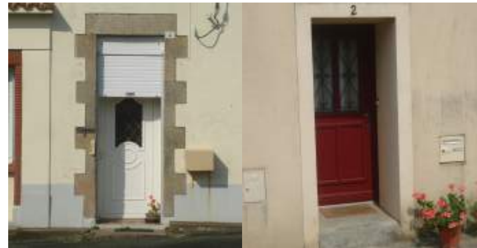
Fig. 72. Exemples de portes trop en retrait par rapport à la façade
